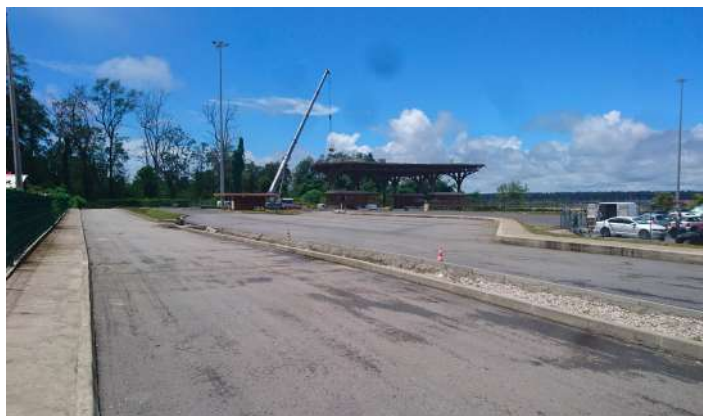
Complexe entrée-sortie. © GPM-Guyane
